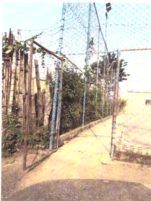
Figura 10 - Portão de Entrada a ser Trocado
